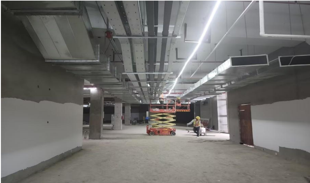
白云城投大厦 管线综合布置现场图
